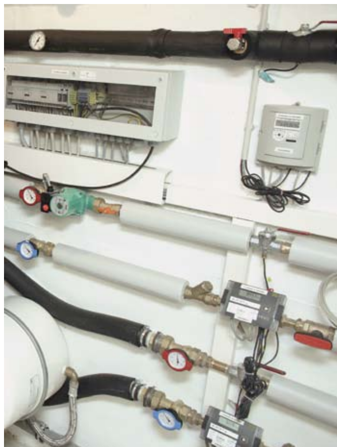
Bild 2 Abgebildet ist ein Teil der installierten Messtechnik bei einer Wärmepumpenanlage
